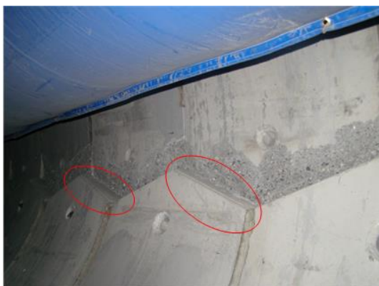
شکل ۱- نمونه‌های پله شدگی و انحراف هندسی خطای نصب سگمنت در تونل انتقال آب گلاب در مجاورت سد تنظیمی زاینده رود
